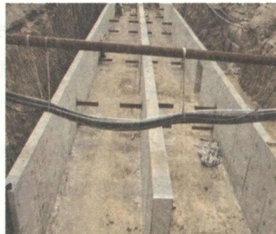
东高地供热管廊
